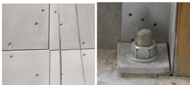
Figura 10. Condizioni di rottura della parete - vista complessiva (in alto), dettaglio scorrimento delle lastre (in basso a sinistra), dettaglio deformazione piastra di base tipo holdown (in basso a destra).
